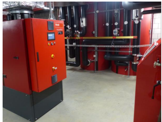
BHKW und Speicher für Heizung
