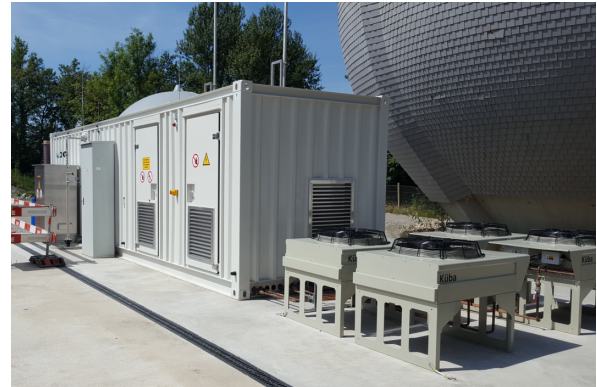
Ansicht einer Gasaufbereitungsanlage
